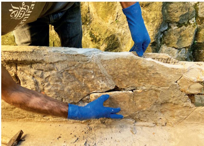
▲ Fig. 3 - ARICCIA, Villino Volterra. Frammenti distaccati
